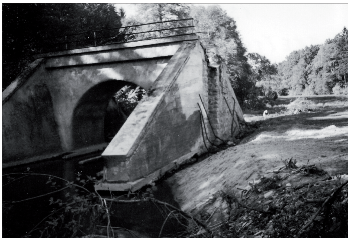
Zničený viadukt – povodeň 2002
